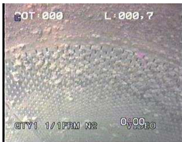
Vue intérieure du captage raccord tube plein / crépines
