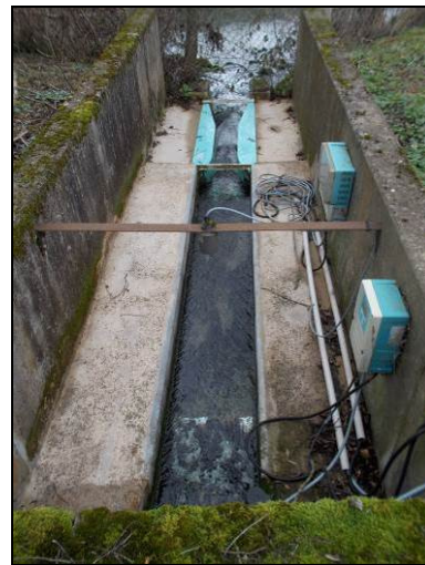
Photo 4 : Trop plein avec station de jaugeage
